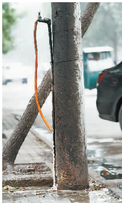
夜市摊点的自来水管绑在行道树上。
