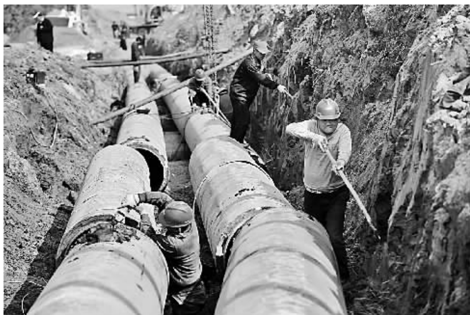
昨日上午,在神火大道与宋城路交叉口南侧,施工人员正在铺设热力管道 晚报首席记者 魏文慧 摄
