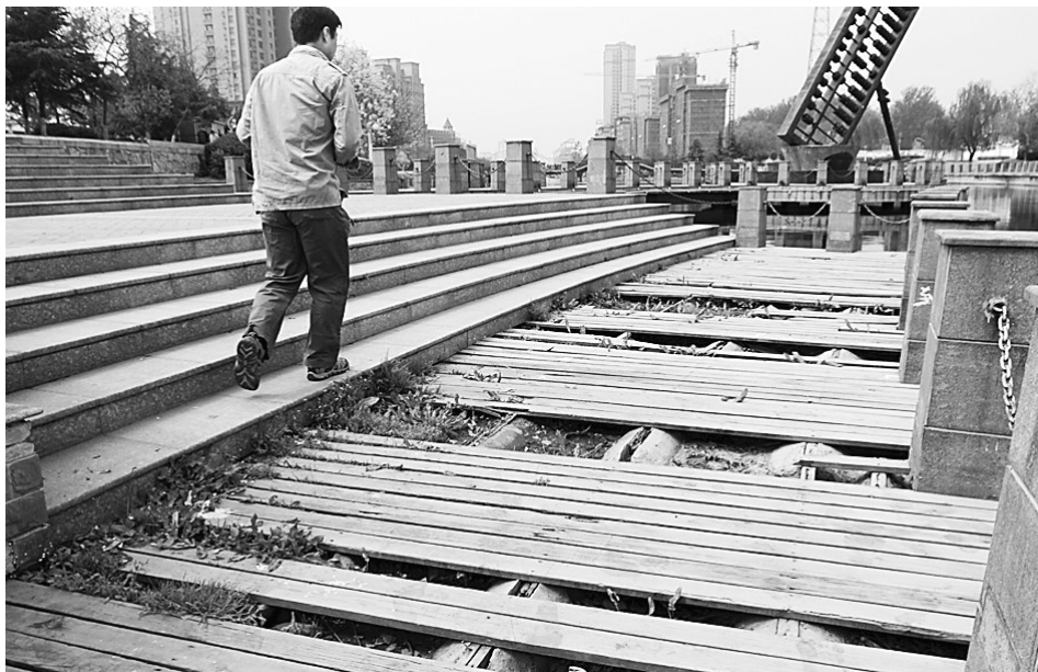
商都广场西侧运河南岸的木栈道损坏严重，行人已无法正常通行 晚报记者 张辉 摄
