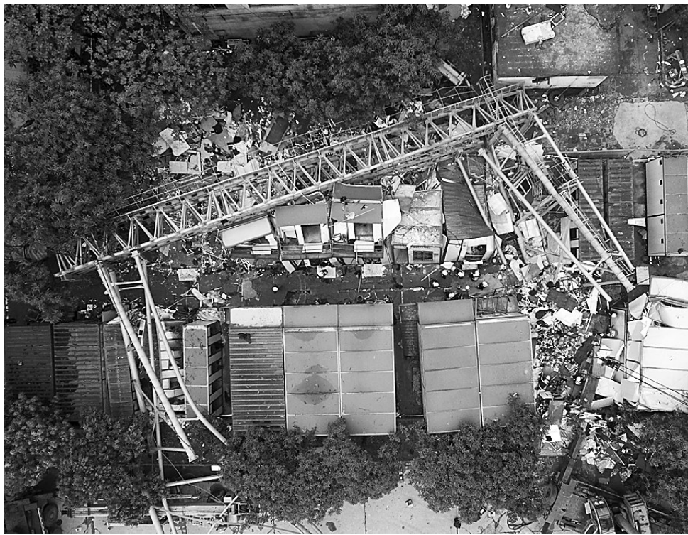
俯瞰龙门架倒塌事故救援现场（4月13日摄） 新华社发
