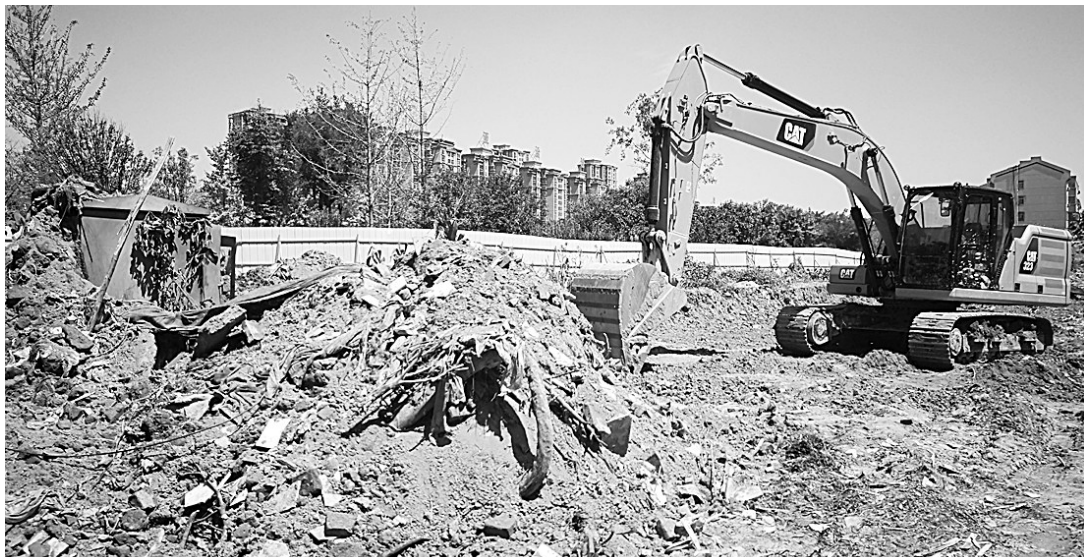
高压供电电缆被挖断后,不见了施工人员的踪影
