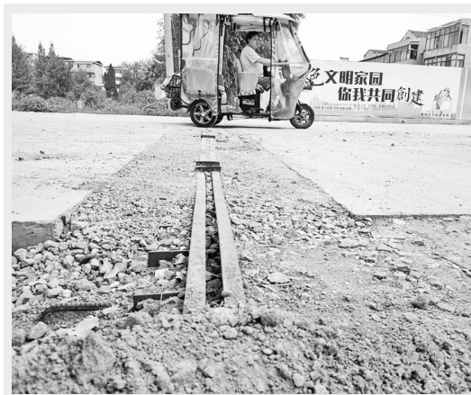
维修前的路面有个凹槽
