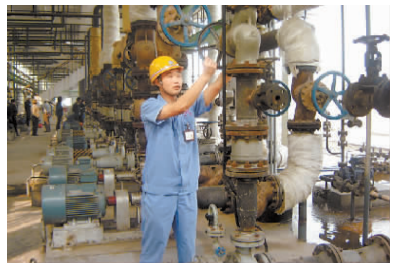
工人正在车间调试机器
