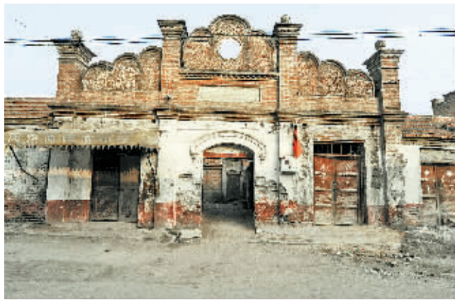
解放一路曾经是朱集镇最古老最繁华的街道之一。解放一路143号这座建筑建于上世纪30年代，当时是所学校。
