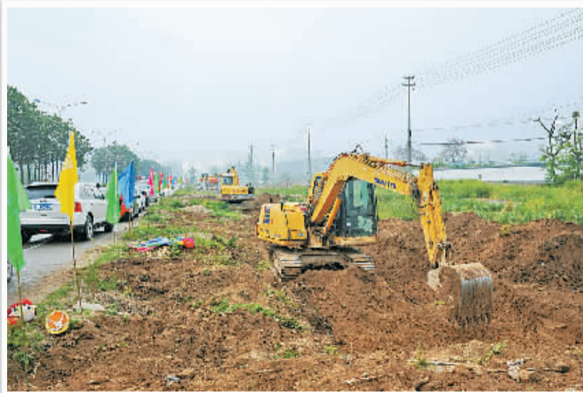
4月27日，归德南路升级改造工程开工。归德南路升级改造工程已列入2015年事关人民切身利益市政府“十件实事”的重点建设项目之一。归德南路升级改造工程北起北海路，向南延伸，终点至连霍高速桥，全长6515.954米。规划红线宽度66米，四幅路形式，双向8车道，计划2015年10月底竣工。
