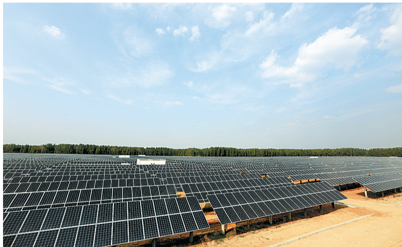
林洋农光互补光伏发电站
