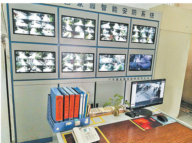
改造后的建业绿色家园监控室显示屏。
