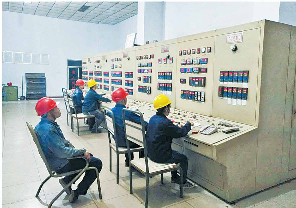
工作人员对锅炉运行状况进行实时监测，确保供热科学管理、合理运行。
