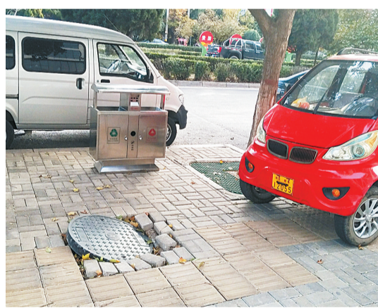
11月13日，南京路与学院路交叉口向西500米路北人行道上，由于遭受外力，一个窨井盖被破坏。据了解，该路段还有不少窨井盖被破坏。 本报记者 那栋 摄
