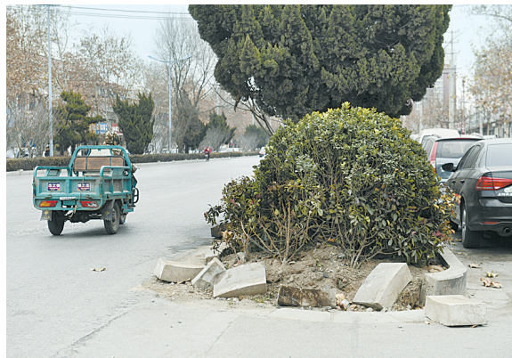
1月8日，位于文化路与昆仑路交叉口东南角的道路绿化带侧石破损、缺失，与整体绿化景观很不协调。
