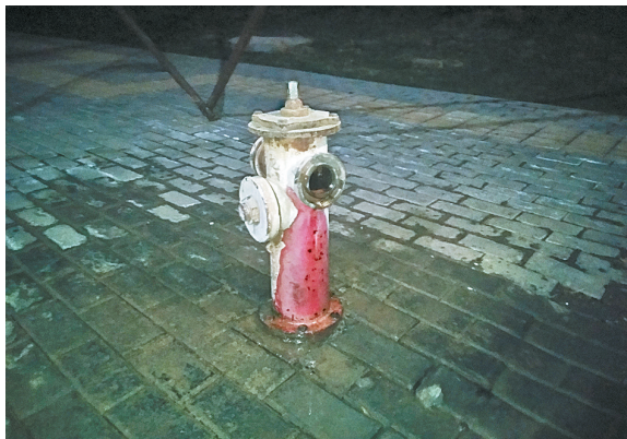
1月8日，帝馨路人行道南侧，消防栓在“哭泣”。除了浪费水资源外，还造成道路结冰，给过往行人带来不便。
