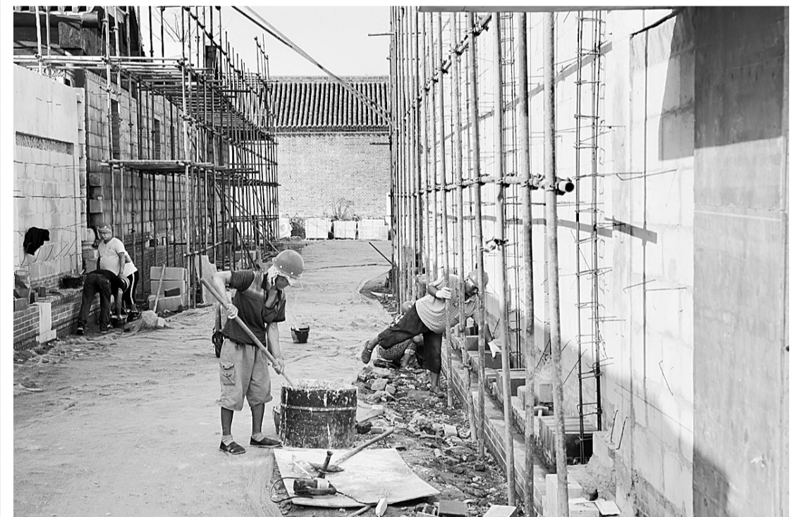
8月23日, 工人在古城府衙维修现场加紧施工。暴雨过后, 古城保护性修复施工方快速清理现场, 进行施工。为了更好地保护古城, 传承历史文脉, 充分体现古城的完整性和真实性, 施工单位按照政府主导、科学规划、整体保护、重点修复、分步实施的原则, 对古城进行保护性修复, 通过对道路重新铺设, 对民居修旧如旧, 对历史文化进行充分挖掘重建, 在不久的将来古城将以崭新面貌迎接八方来客。 本报记者 邢栋 摄
