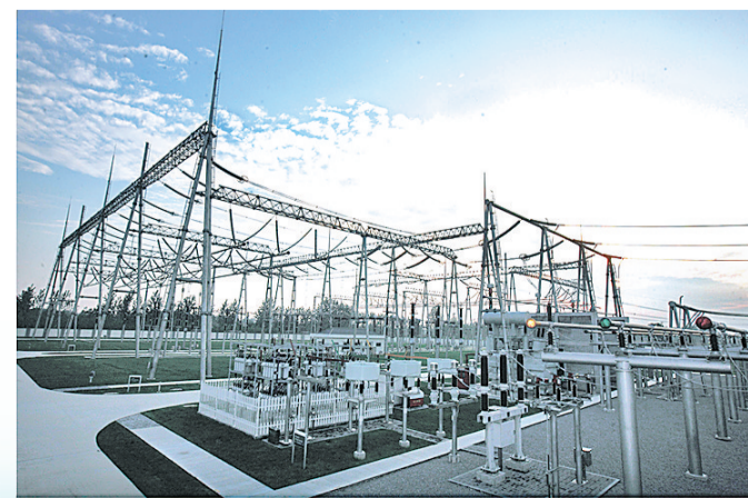
2007年10月，商丘第一座500千伏变电站——庄周变电站建成投运。
