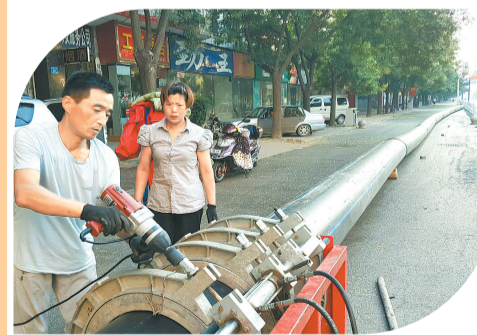
▲7月25日，夏邑县城市管道施工人员在热力对接水管，提升污水治理水平。本报记者 韩丰 摄
