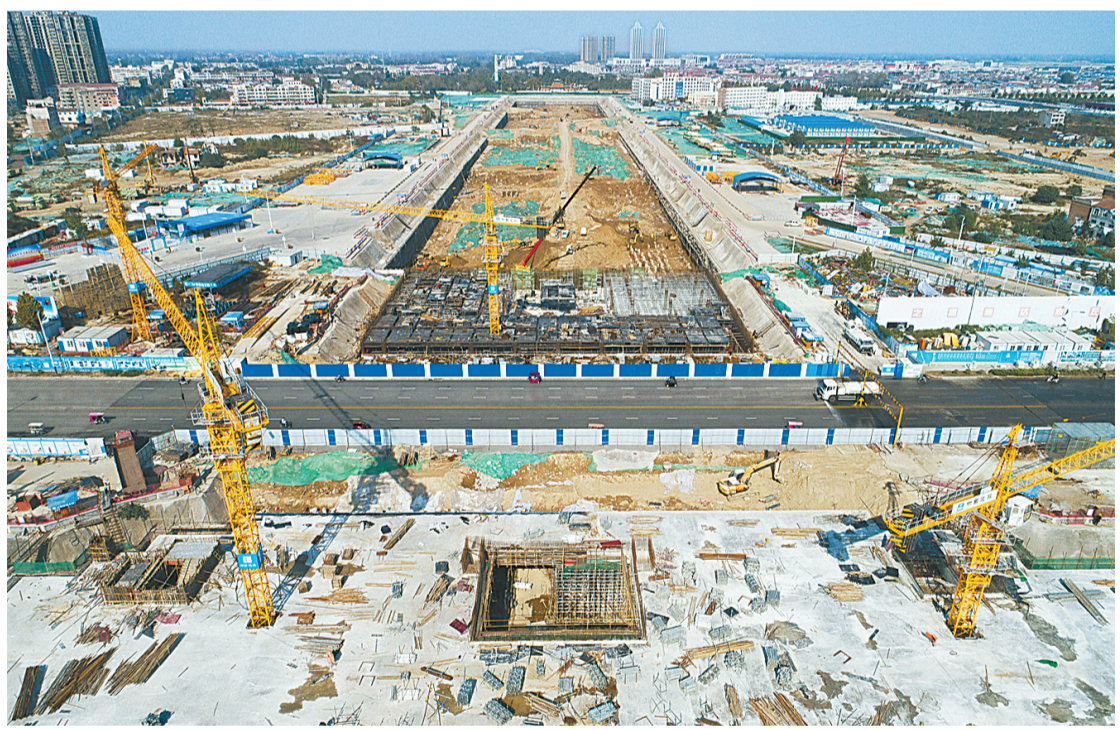
11月4日,航拍高塔林立的中央绿轴广场施工现场。总投资10亿元的梁园高铁核心区中央绿轴广场项目南接高铁广场,北依人民公园,是高铁新城和高铁站之间一个重要的开放空间和商业文化中心。项目建成后,将为商丘市民和到访游客提供高端的城市环境和丰富的文化享受。 本报记者 崔坤 摄
